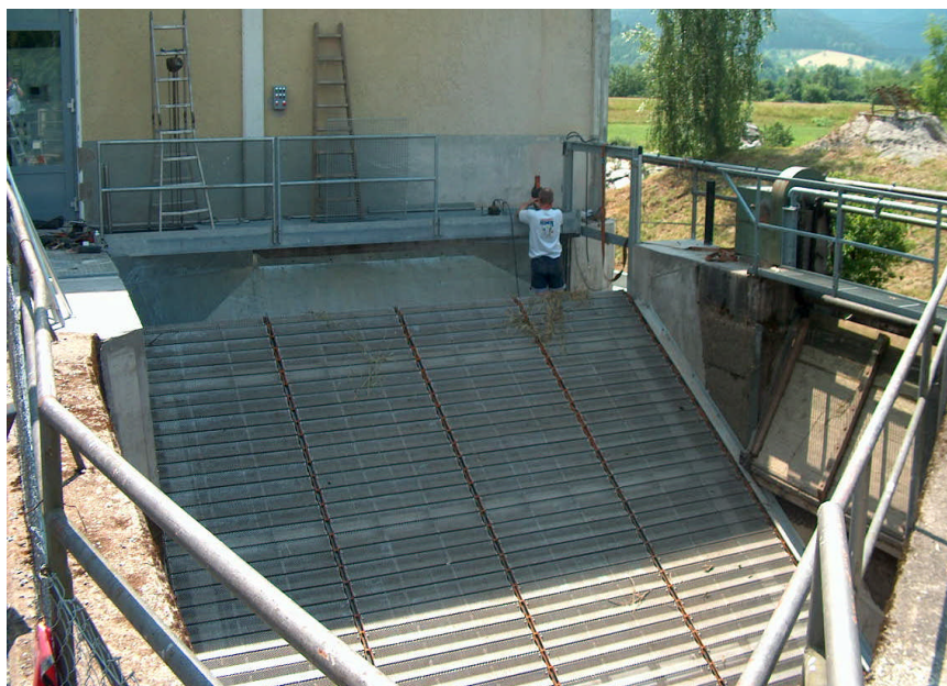
Abbildung 6: Anlage „Steinach CR“ in der Bauphase: rechteckig zur Fließrichtung angeordneter Lochblechrechen mit flacher Neigung, seitliche Bypassöffnung noch nicht installiert;
